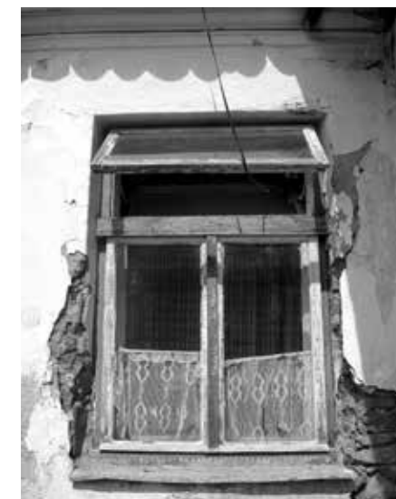
HAVARIJNÍ STAV PŘED OBNOVOU
