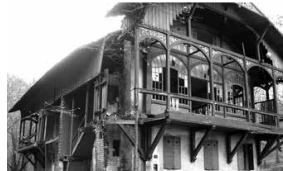
DO OBJEKTU ZATÉKALO, PŘÍZEMÍ BYLO ZDEVASTOVÁNO A VITRÁŽOVÁ OKNA BYLA VE VELKÉ MÍŘE VYBITA.
