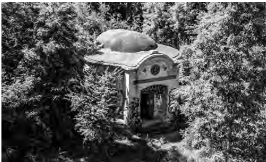
KAPLE PANNY MARIE BOLESTNÉ NA PRAŽSKÉM BARRANDOVĚ JE V SOUČASNÉ DOBĚ V NEUTĚŠENÉM STAVU. O JEJÍ ZÁCHRANU SE OD LOŇSKÉHO ROKU STARÁ SPOLEK PRÁZDNÉ DOMY.
