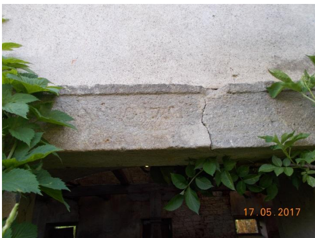
Obr. č. 12 – zničený portál s letopočtem
