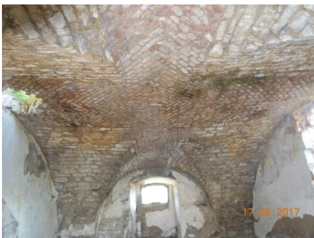
Obr. č. 2 – poslední nezřícené klenby chléva I.
