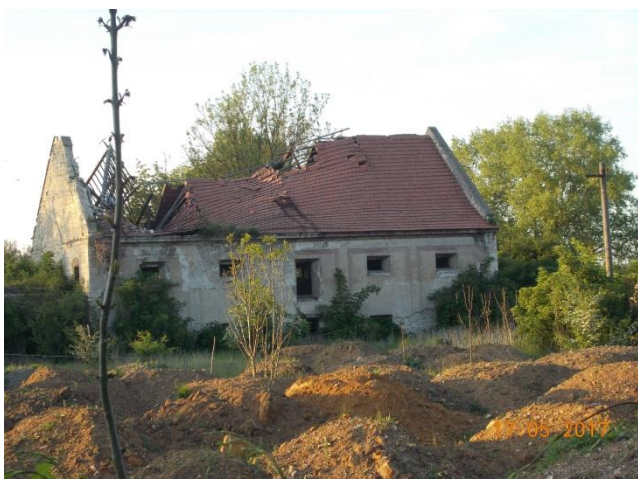
Obr. č. 10 – sýpka, propadající se střecha
