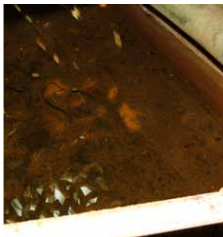
Obr. 20: Nevhodně spádovaný terén okolních ploch, dochází ke kumulaci vody při patě zdiva, které následně vniká ke konstrukcím objektu
