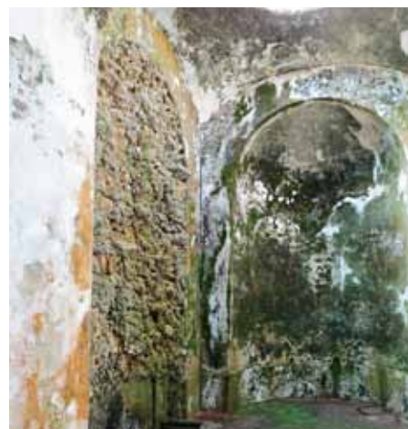
Obr. 12: Lví fontána, přívod vody do kašny, JZ roh objektu, extrémní zavlhčení i vlivem vpusti terasy a destrukce šachty (viz obr. 3)
