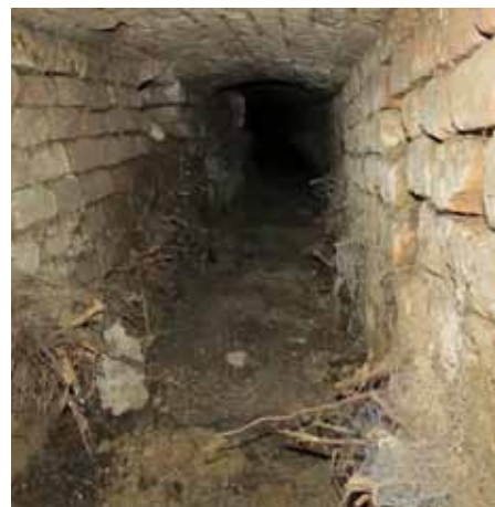
Obr. 11: Poškození kanálu prorůstáním kořenů stromu
