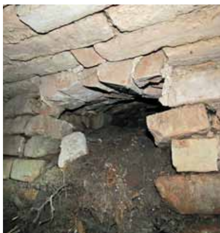
Obr. 3: Cihelná šachta pod vpustí zaústěná do kanálu, zdivo se rozpadá a dešťová voda prosakuje do okolního zdiva a kleneb
