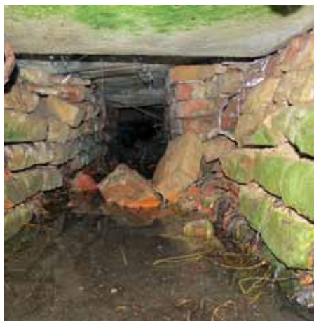
Obr. 9: Rozpad zdiva a kumulace vody v odvodňovacím kanálu
