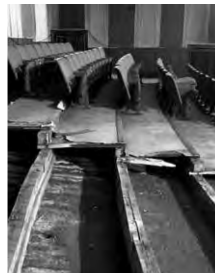
PODLAHU NAPADENOU DŘEVOMORKOU BYLO NUTNO ODSTRANIT.
