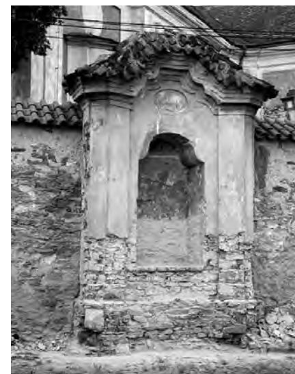
BAROKNÍ KAPLE PŘED OBNOVOU
