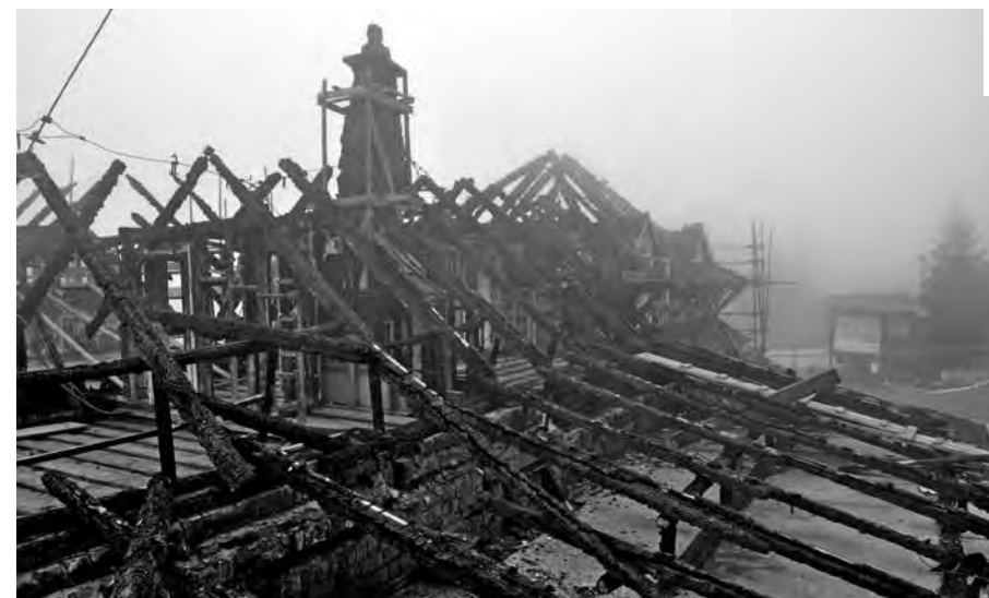
VEŘEJNÁ SBÍRKA NA ZÁCHRANU PUSTEVEN BYLA VYHLÁŠENA KRÁTCE PO POŽÁRU V ROCE 2014.
